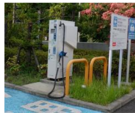
立川合同庁舎急速充電設備
