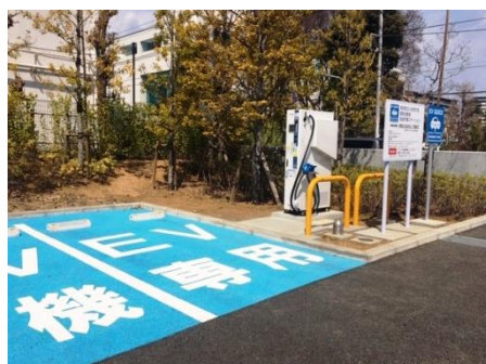
<都有施設の公共用充電器(立川合同庁舎)>
