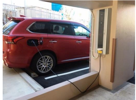
＜集合住宅に設置された充電器設置例＞
