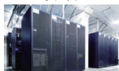
データセンター
