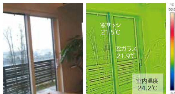
南西側外壁及び窓面のサーモ画像（1月上旬 17:00）
