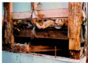
写真 | 土台・柱下部が腐朽した例
