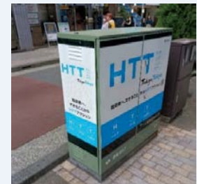
<配電地上機器を活用した屋外広告>
