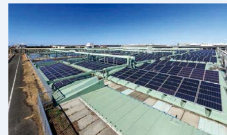
＜都内導入事例（太陽光発電）：森ヶ崎水再生センター＞
