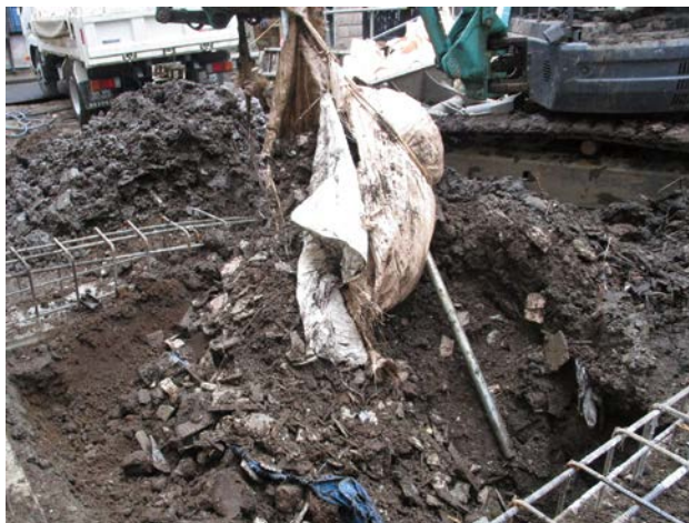
建設現場基礎への不法投棄（掘起し作業）
