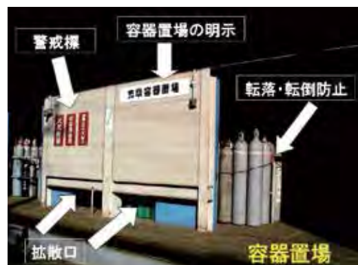
高圧ガスの貯蔵例（資料）経済産業省 貯蔵とは、容器や貯槽に高圧ガスを充てんして、貯めておくこと。写真は容器置場における貯蔵例。
