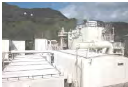
八丈島地熱発電所
