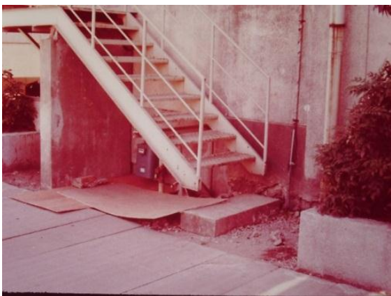
写真 1-3-1 地盤沈下により、宙に浮いた階段
