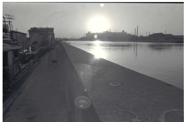
写真 1-3-2 地表面より運河の水が高くなっている様子
