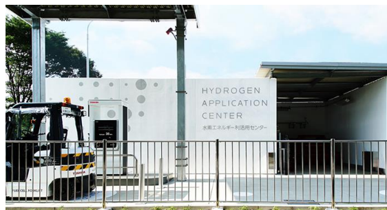
水素ステーション(太陽光と水から水素をつくり使用)
