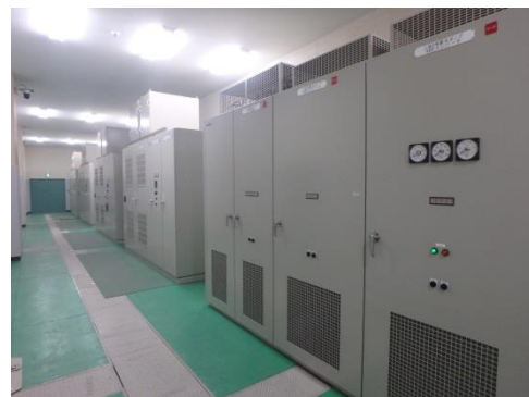
送配水ポンプ用インバータ装置
