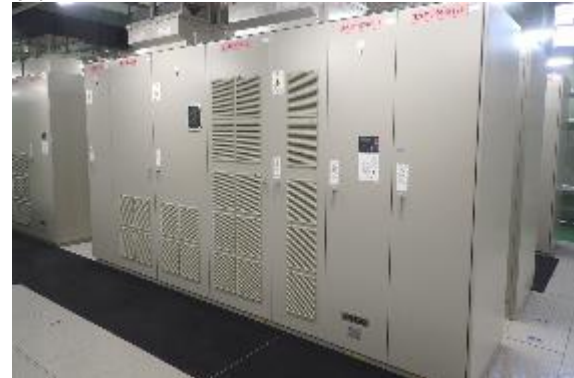
図 1 送水ポンプ用インバータ装置
