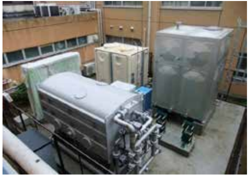
吸着式冷凍機・冷温水タンク
