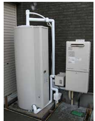
蓄熱槽：春～秋に集めた熱でお湯をつくる。
