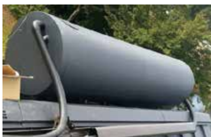
太陽熱温水器の貯湯タンク
