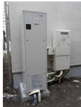
蓄熱槽・ガス給湯器
