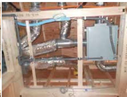
間接気化式冷却器設置状
