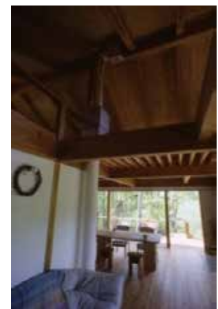
ファンとダクト
