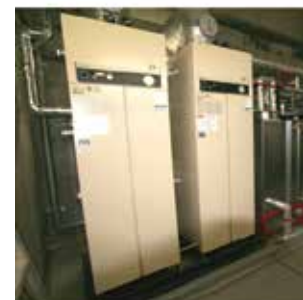
補助熱源（ガスボイラ）
