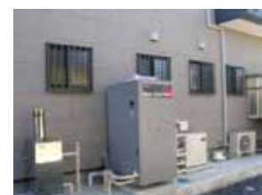
蓄熱槽 (370ℓ) 緊急時に生活水 として使用可能
