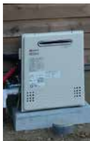
補助熱源（ガス給湯器）
