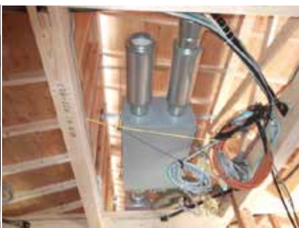
デシカント空調機設置状況
