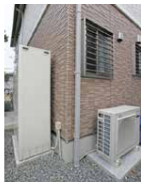
蓄熱槽・ヒートポンプユニット
