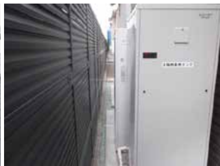
蓄熱槽外観 (太陽熱・エコジョーズ)
