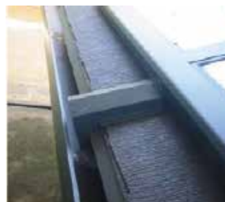
軒先の配管化粧カバー
