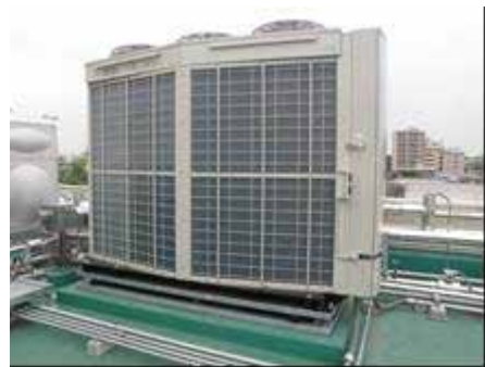
高効率ヒートポンプチラー（補助熱源）
