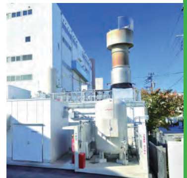
▲都市ガス製造供給設備
