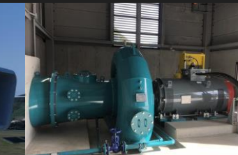
長野県小布施 0.2MW 小水力
