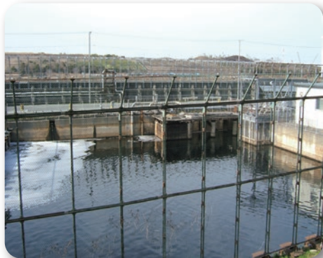
集水池（ポンプ井）
