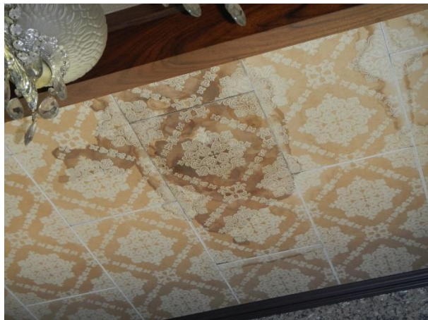
ハクビシンによる家屋侵入による建物の汚損
