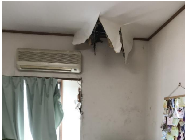
アライグマによる家屋侵入による建物の破損
