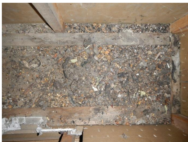
ハクビシンによる糞による汚損
