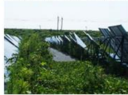
不十分な管理で放置されたパネル
