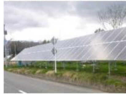
柵塀の設置されない設備
