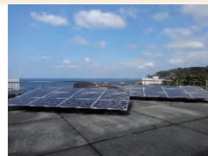
都の補助制度を活用して設置した 神津島村の太陽光発電設備
