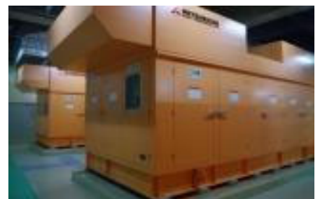
【コージェネレーションシステム】
