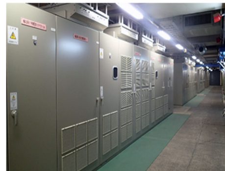
図1. 送配水ポンプ用インバータ装置
