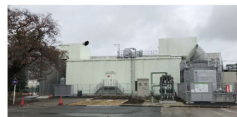
ガスエンジンCGS
