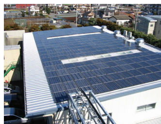
太陽光発電システム
