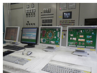
エネルギー監視システム
