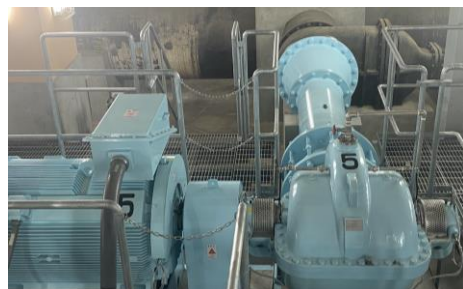
図 1 配水ポンプ本体及び電動機
