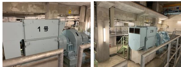
図 1 送水ポンプ本体及び電動機
