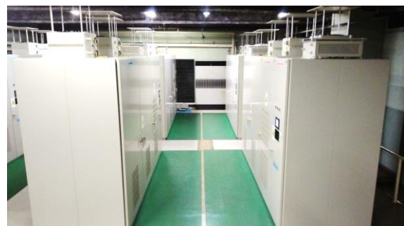
図 2 送水ポンプ用インバータ装置
