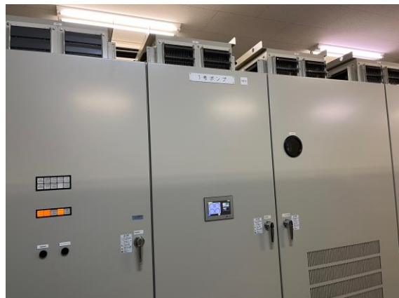
図 2 送水ポンプ用インバータ装置
