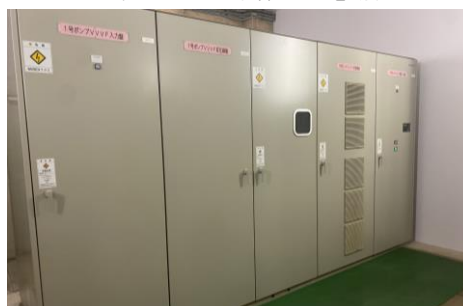
図 2 配水ポンプ用インバータ装置
