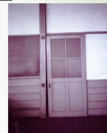
写真3：閉まらなくなった小学校の扉（昭和38年 北区）
