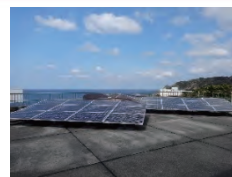
都の補助制度を活用して設置した 神津島村の太陽光発電設備
