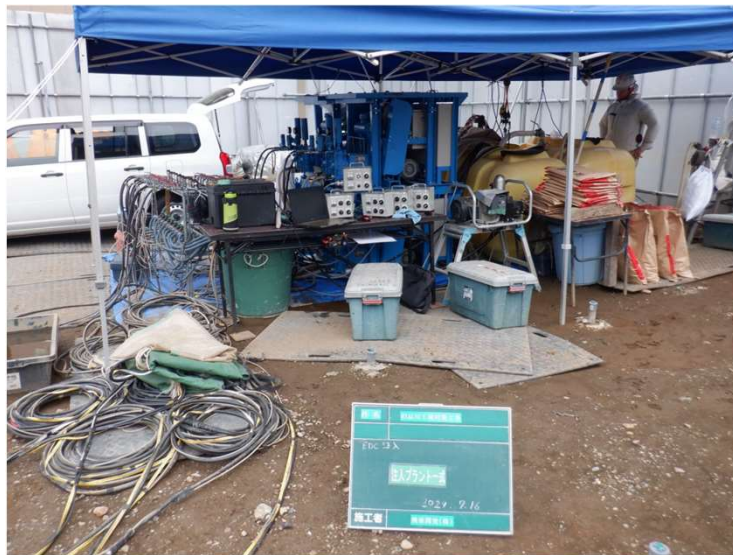
注入プラント
