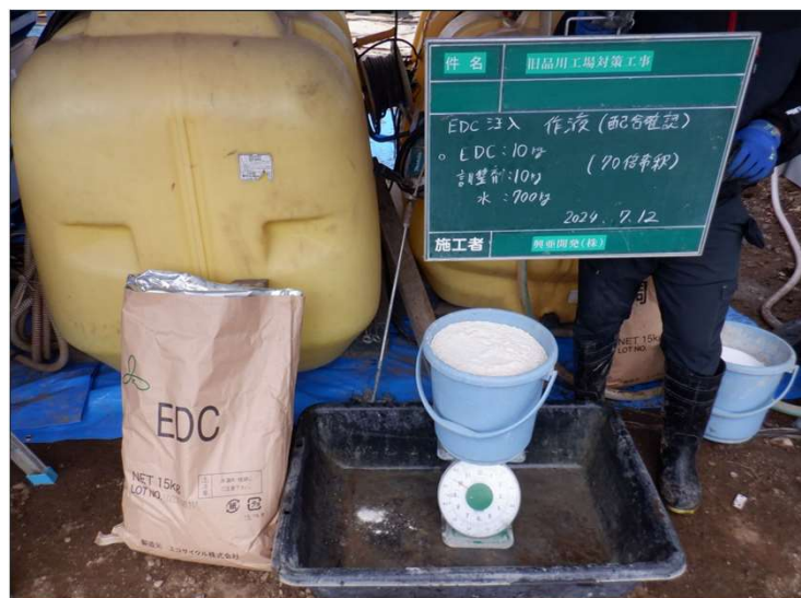
浄化剤EDCの計量
