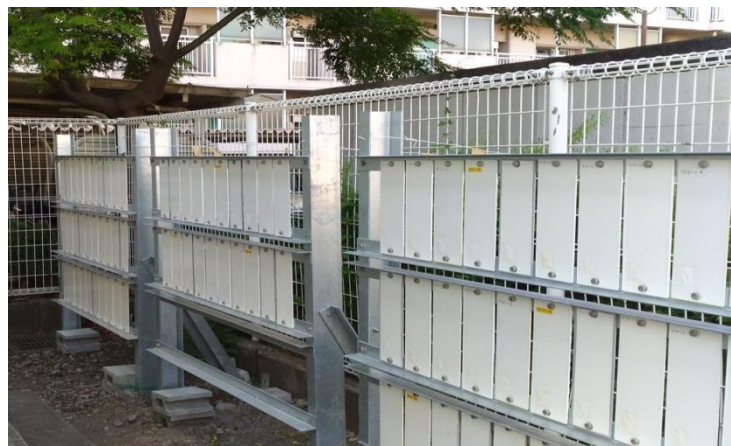
亀戸測定局施設内
