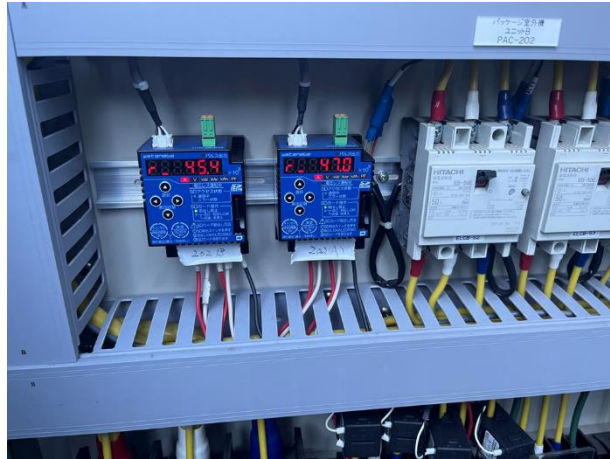
図 1. 電力計測装置設置場所(分電盤)内の状況
