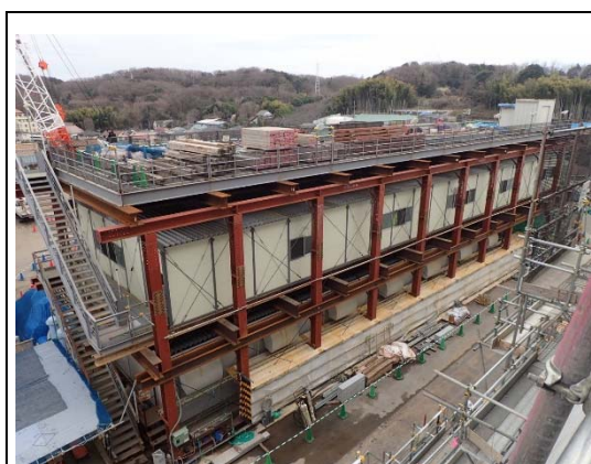
写真-1 諸設備の重層化（地点 02）
