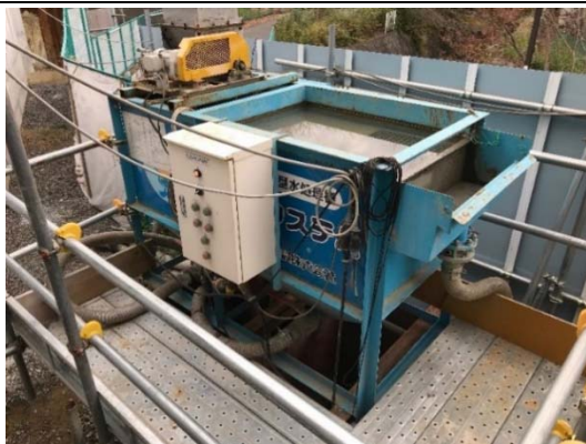
写真-3 濁水処理設備の設置状況（地点 02）
