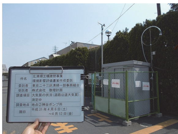
神谷ポンプ所 地点②
