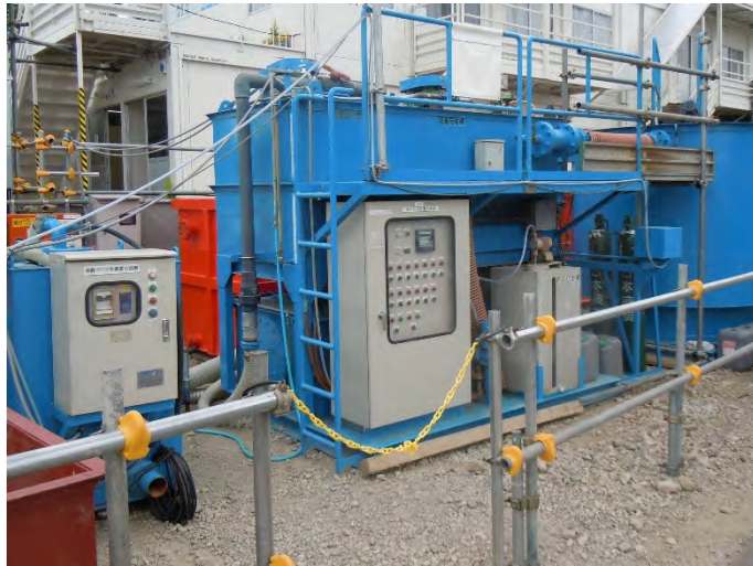
写真 3-4 濁水処理設備の状況
