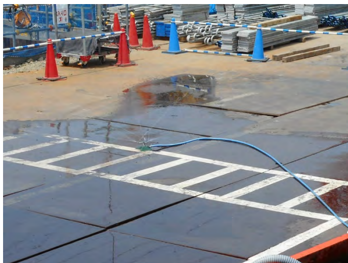
写真 1-6(2) 対象事業実施区域の散水の状況（スプリンクラー）
