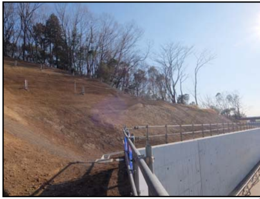
擁壁側からの眺め
