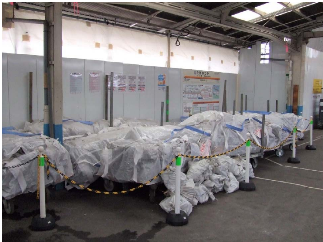
写真2-10 石綿含有材料の作業場内保管（専用袋による二重梱包）状況（平成30年10月3日）
