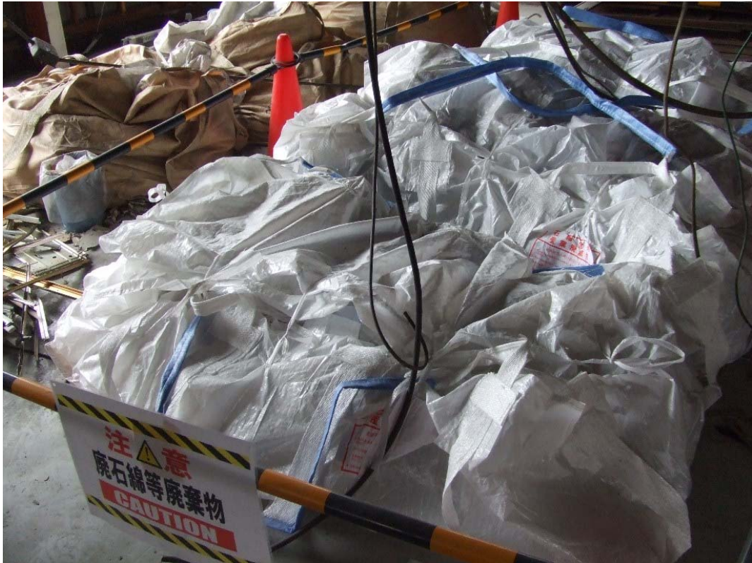
写真2-9 石綿含有材料の作業場内保管（専用袋による二重梱包）状況（平成29年10月5日）
