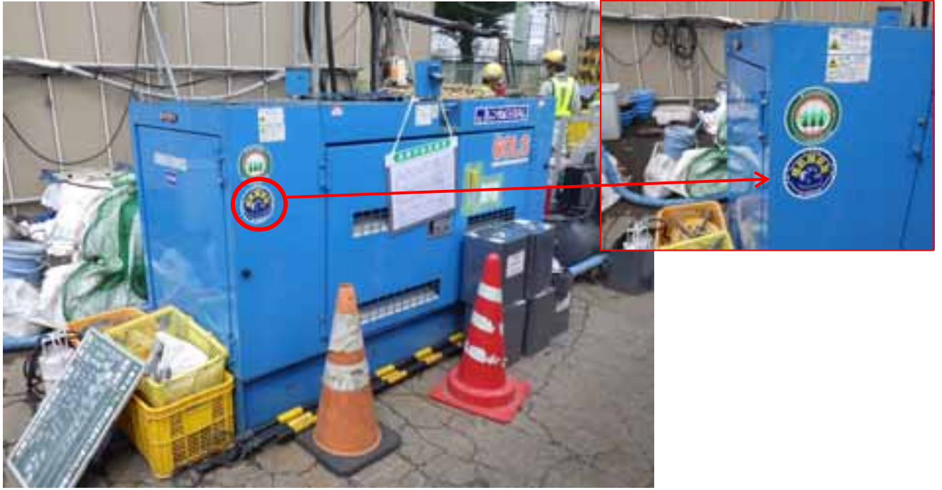
写真1-32 超低騒音型の機械の使用（発電機）（平成29年9月5日）
