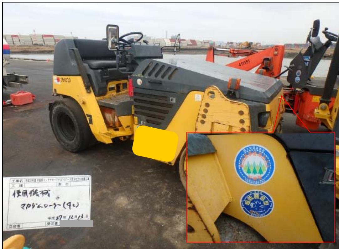
写真3-4(3) 排出ガス対策型・超低騒音型建設機械の使用状況 (マカダムローラー:SAKAI TW502)
