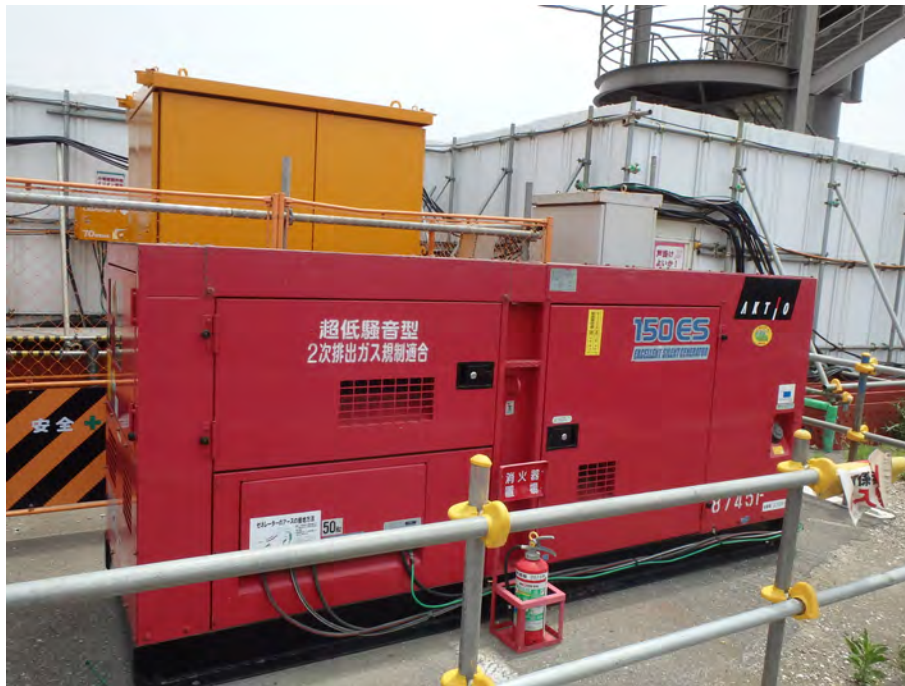
写真2-5 超低騒音型、2次排出ガス規制適合発電機の使用状況
