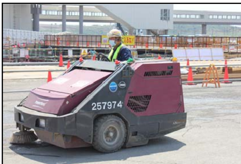
写真7-8 清掃車の使用状況
