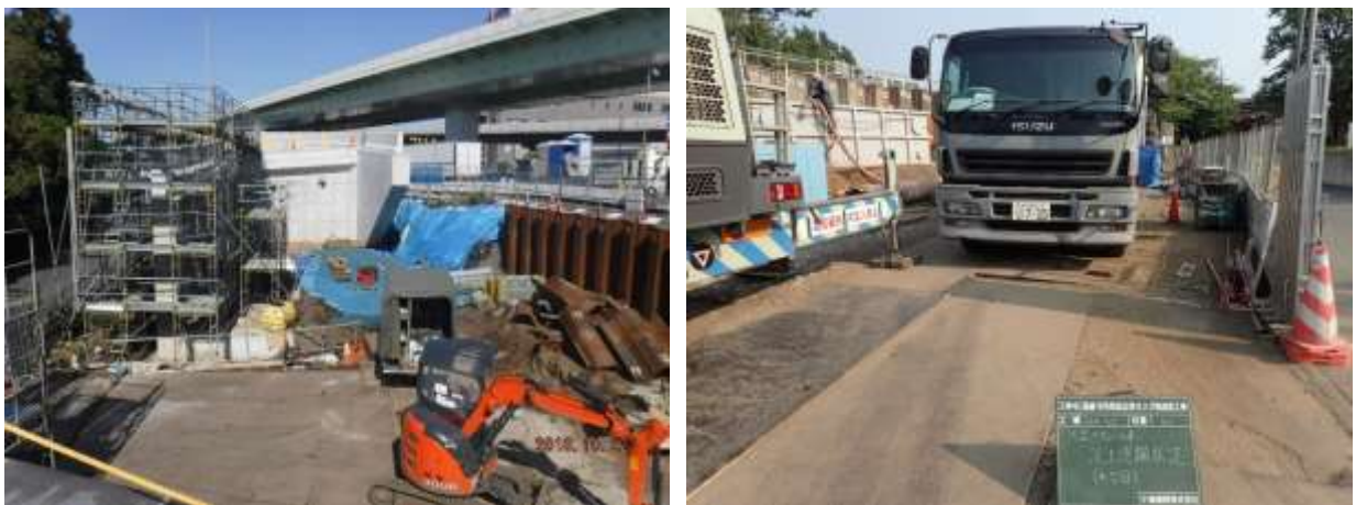
写真 4-5 環境保全のための措置の実施状況（泥・土付着防止のための敷鉄板設置）
