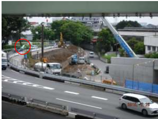
写真 4-4 環境保全のための措置の実施状況（吹き流しによる風速の確認）
