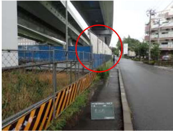
写真 4-3 環境保全のための措置の実施状況（防護フェンス）
