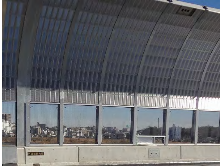
図6.1-1(2) 環境保全のための措置（吸音パネルの設置）
