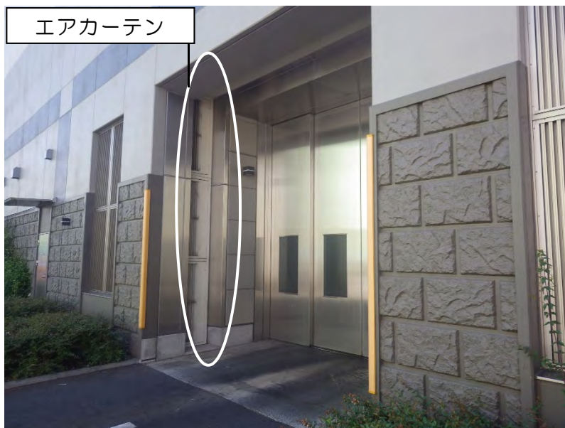
写真6-3 プラットホーム出口のエアカーテン
