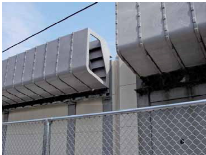
写真 6.1-3 干渉型防音装置
