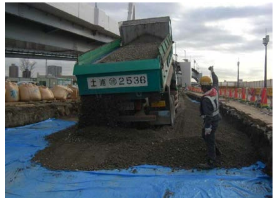
写真 1-4 環境保全のための措置の実施状況 (仮置き時の分離保管)
