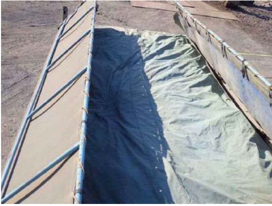
写真 1-1 環境保全のための措置の実施状況 (ダンプトラックによる汚染土壌運搬時の飛散防止対策)
