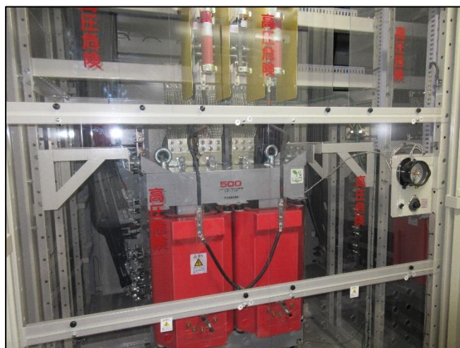
写真 6.8-3 省エネ型のトッランナーモールド変圧器の導入
