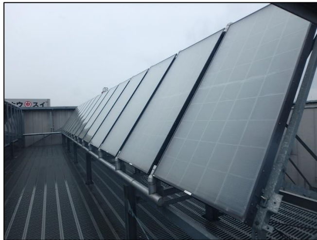
写真 6.8-5 太陽熱の利用状況
