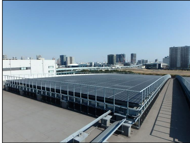
写真 6.8-1 太陽光発電の設置
