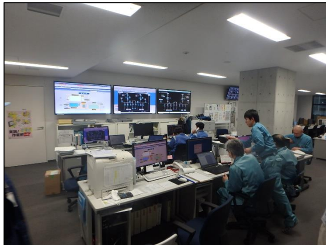
写真 6.8-2 中央監視システムの導入
