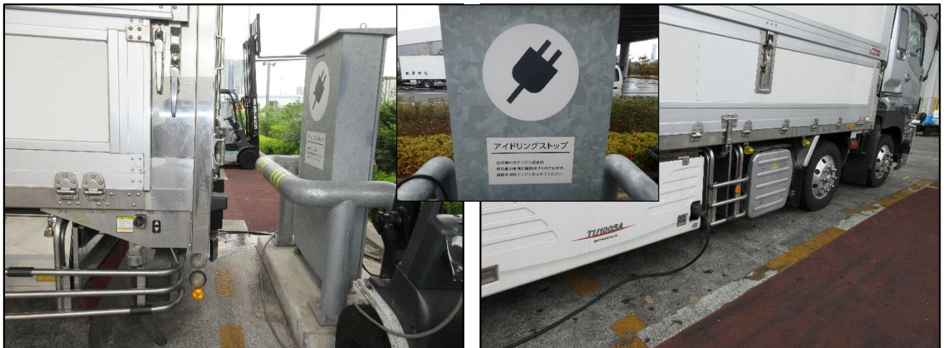
写真 6.1-7 冷蔵車・冷凍車に接続するアイドリングストップ盤
