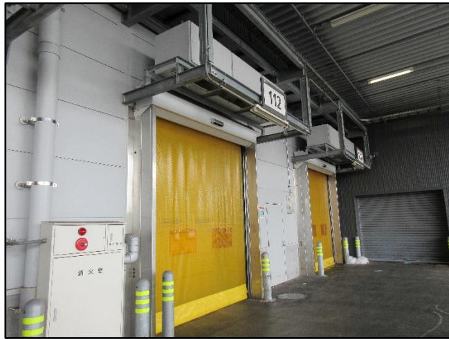
写真 6.2-1 シートシャッター
