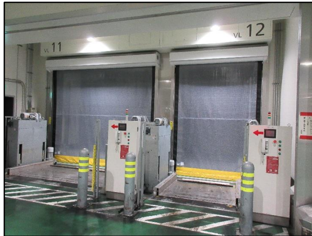
写真 6.1-2 垂直搬送機（7 街区：水産卸売場棟）
