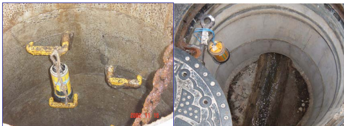
写真 6 硫化水素濃度連続測定器設置例
