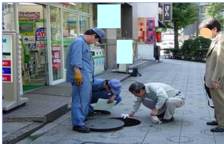
写真 1 ビル管理者等立会のもと硫化水素発生状況確認
