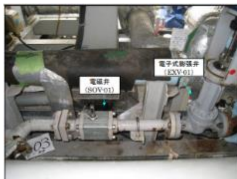
写真 8.4 電磁弁と電子式膨張弁の設置状況
