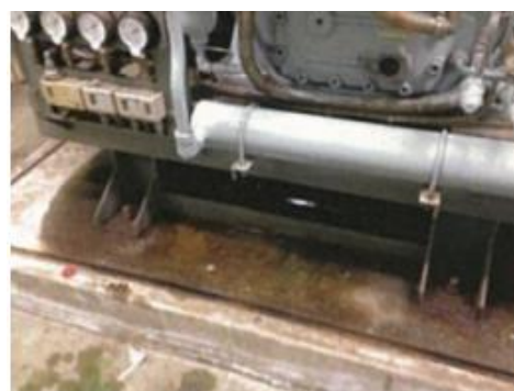
写真 8.12 冷媒の漏えい状況
