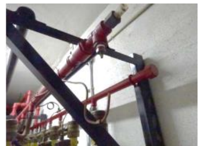
写真 8.28 二酸化炭素が放出したとみられる圧力伝達配管(銅管)接続部
