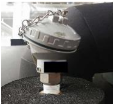
写真 8.10 低圧の圧力発信器取り付け部
