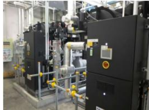
写真 8.7 機械室内の冷凍設備設置状況
