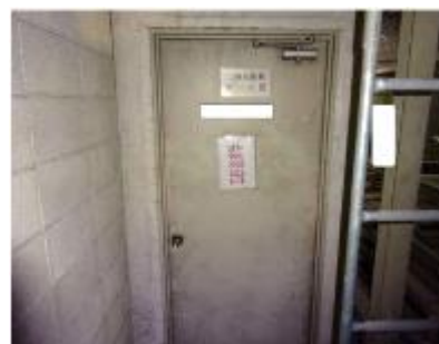
写真 8.23 二酸化炭素容器室入口
