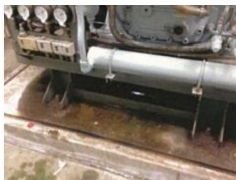
写真 8.12 冷媒の漏えい状況
