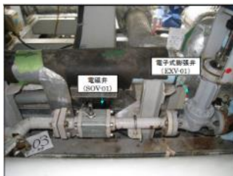
写真 8.4 電磁弁と電子式膨張弁の設置状況
