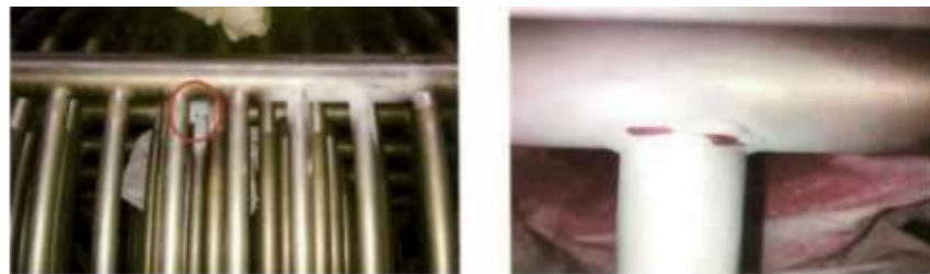
写真 8.21 蒸発器の冷媒コイルの溶接継手(ヘッダーとコイル)の浸透探傷試験結果
