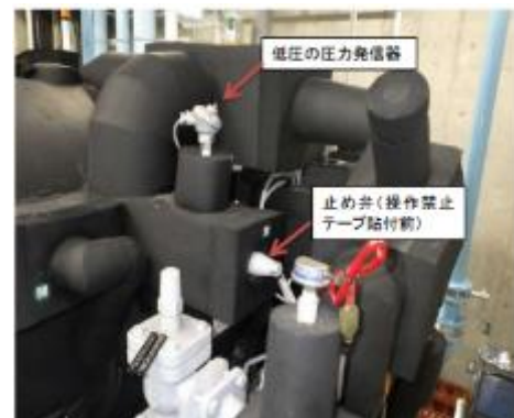
写真 8.9 低圧の圧力発信器及び 操作禁止テープ貼付け前の止め弁
