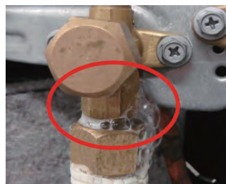
フロン漏えいの様子
