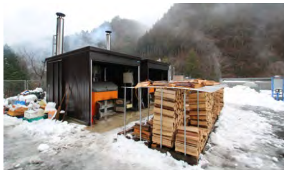
檜原温泉センターの薪ボイラー 54
